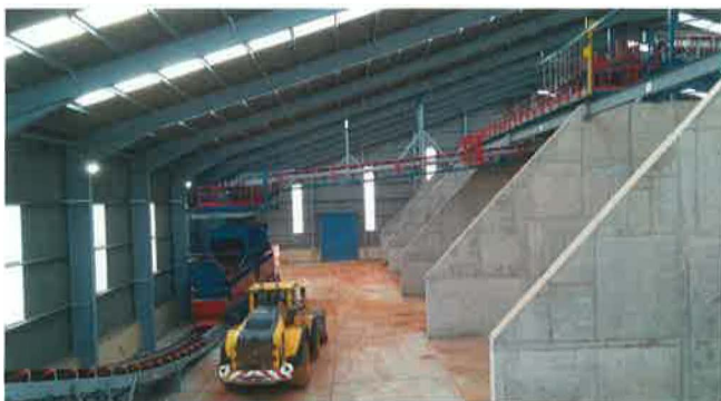
»2 Clay storage »2 Tonlagerboxen
